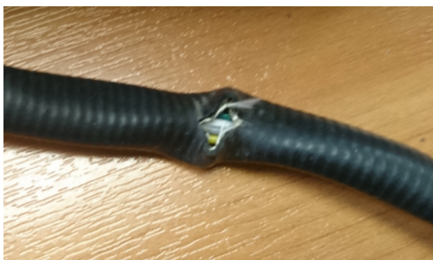
Figura 13. Figura 13. Protector de cable dañado.
